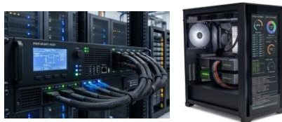
電源管理系統
